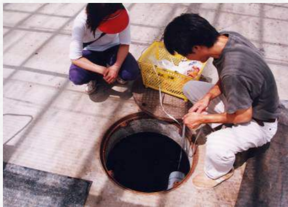
図3-13 循環タンクへの設置
