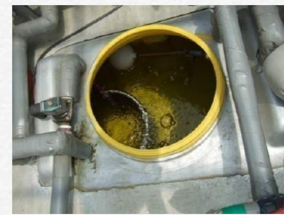
図3-17 循環タンク内に設置
