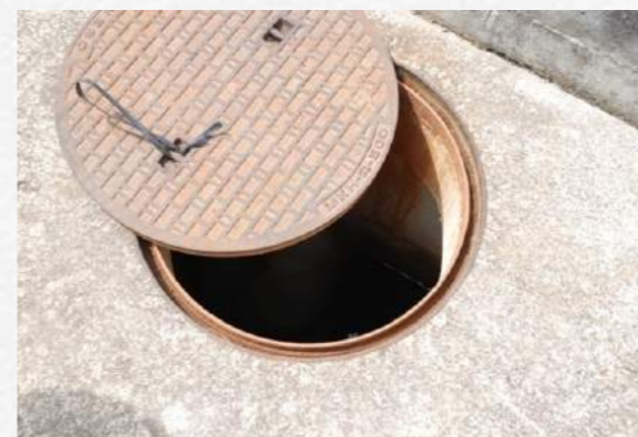
図3-20 原水タンク内に設置
