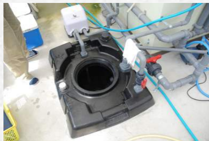
閉鎖系苗施設の循環養液タンク
